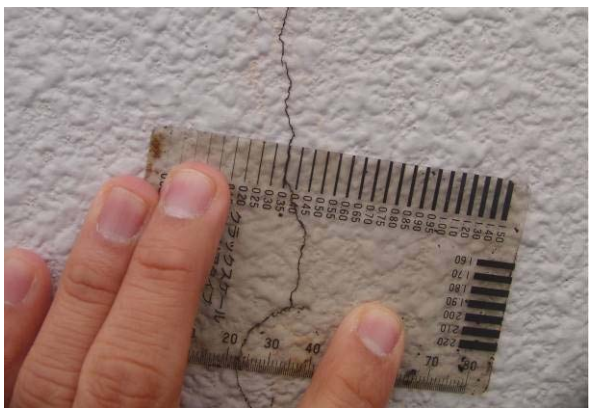
[写真 B] 海と反対側の外壁のひび割れ状況
