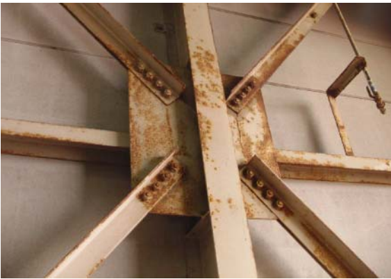
[写真 B]間柱の錆状況
