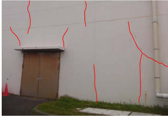
[写真 A] 外壁面のひび割れ状況
