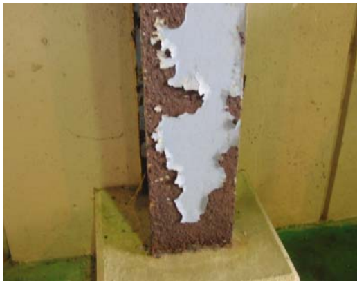
[写真 B]間柱の錆状況
