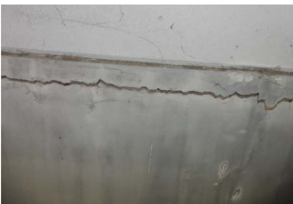
[写真 B]ALC 取り合い部ひび割れ状況
